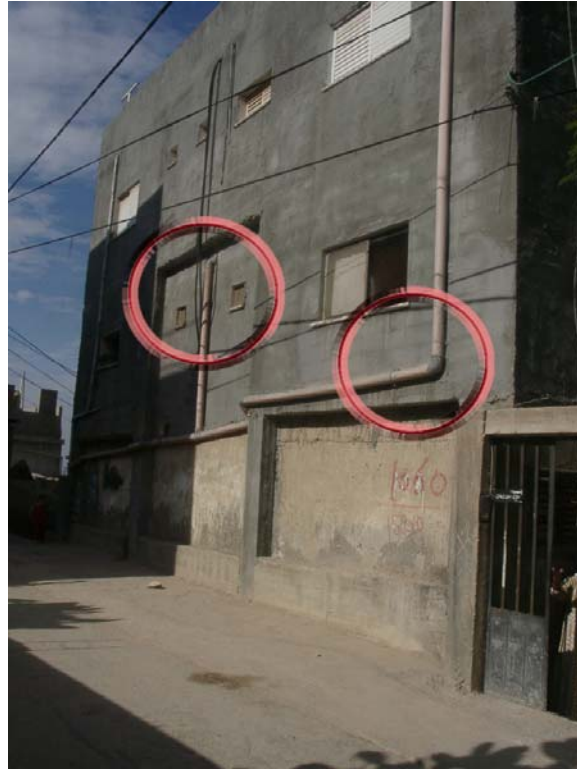
صورة رقم (4:52) أنابيب الصرف الصحي تشوه الجدران.
